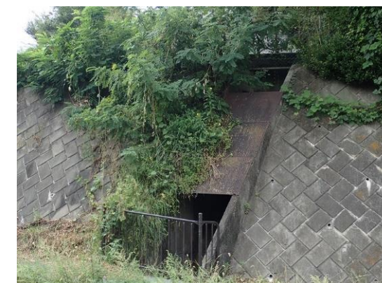
(c) 伊勢宮余水吐 余剰の水を放流するための設備
